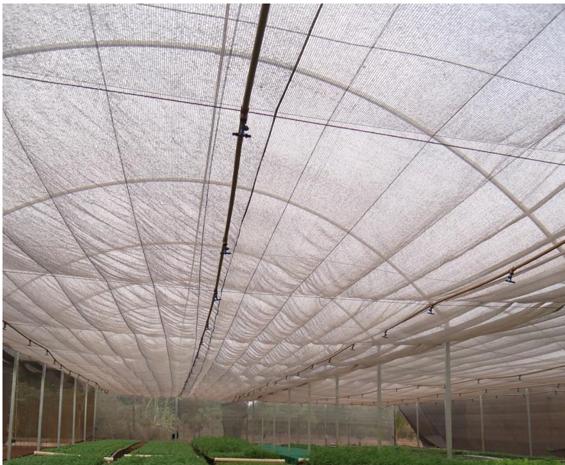
Figura 14. Sistema de aspersores instalados na estufa. Goianira-GO. Fonte: Patrícia Damásia, 2014.
