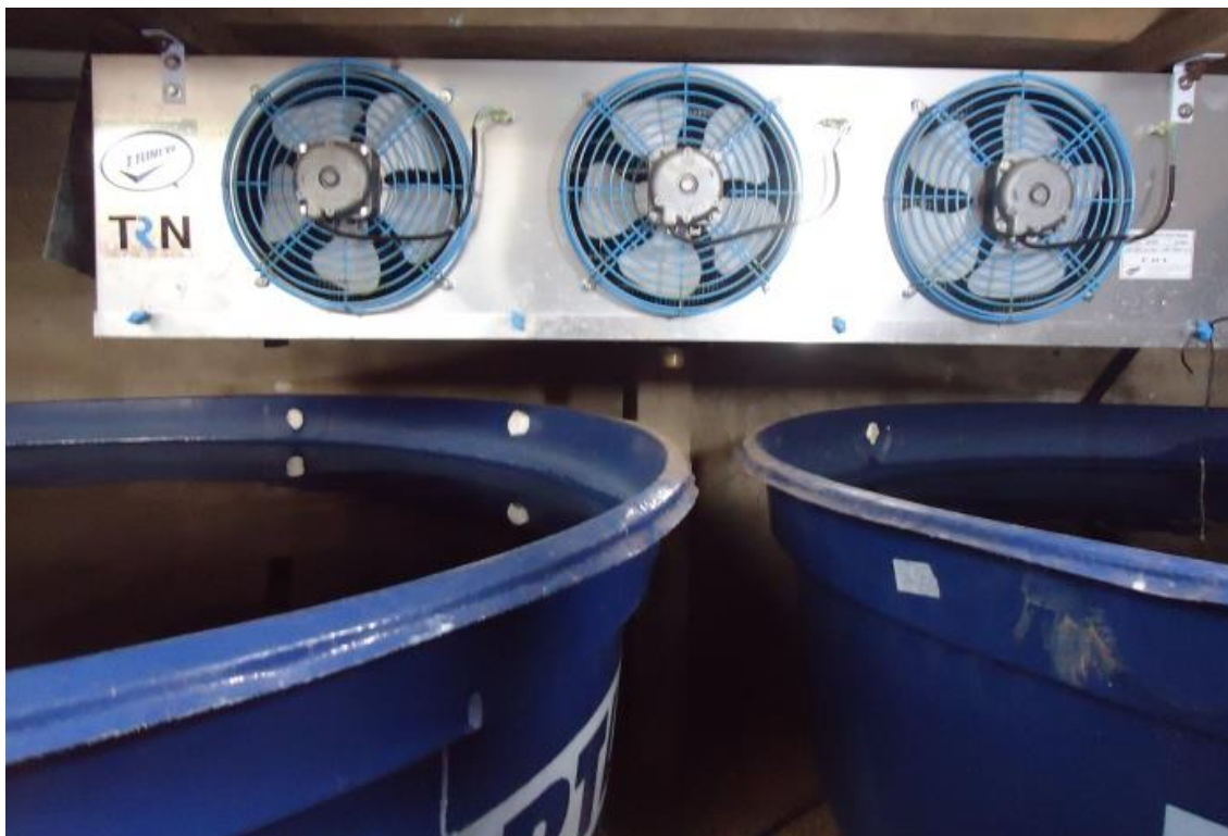
Figura 13. Sistema de refrigeração para reduzir problemas com alta temperatura. Jussara-GO. Fonte: Patrícia Damásia, 2014.
